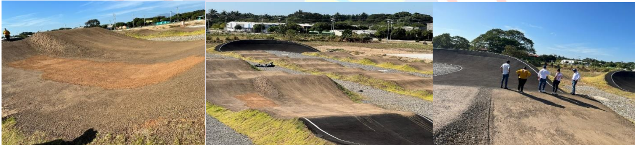
Pista BMX Tramos relleno seleccionado compactado y mezcla densa en caliente (Asfalto)
