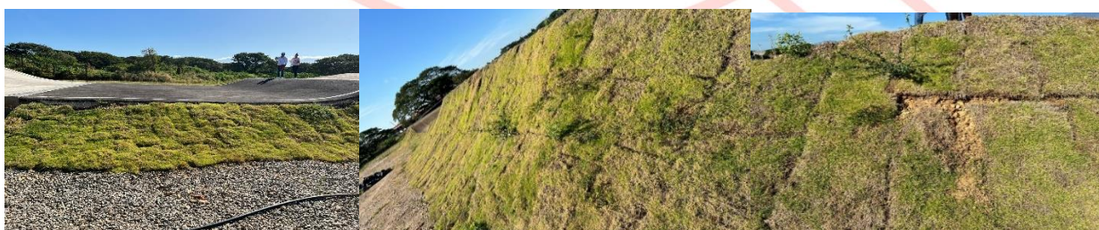
Erosión en los taludes de la pista
